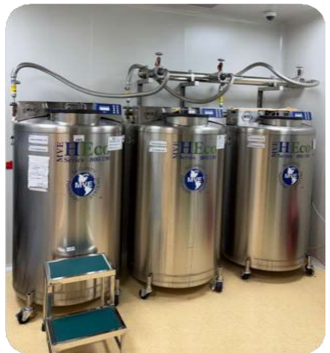
Tangki Penyimpanan Nitrogen Cecair digunakan Untuk Penyimpanan Jangka Panjang WJ-MSC
